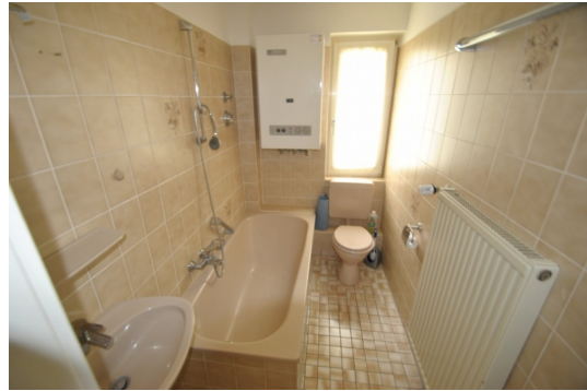
Badezimmer mit Gasetagenheizung
